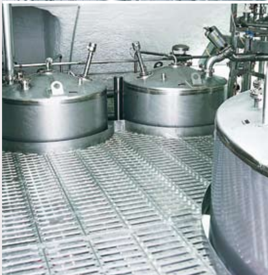
CIP-Anlage, Paulaner Brauerei, München
